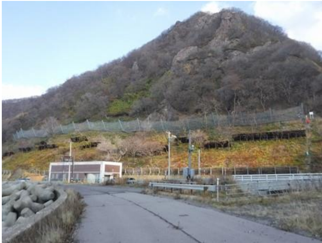
落石防護柵工
