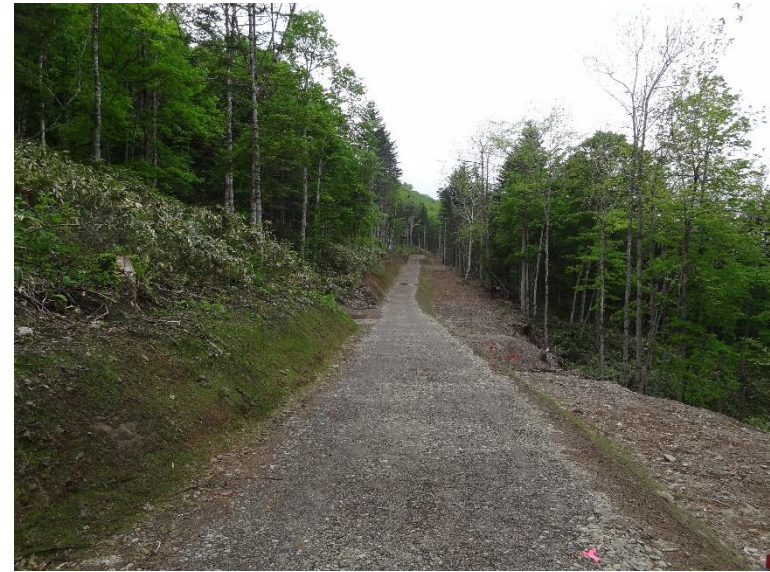
松山1号林道(林業専用道)新設工事及び岩山林道(林業専用道)改良工事 北海道美瑛町 新谷建設(株)
