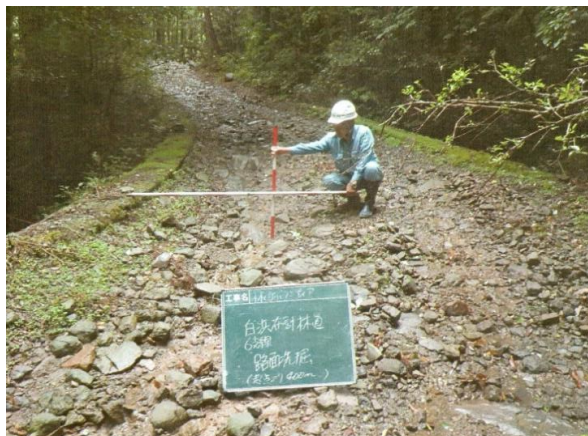
集中豪雨による路面洗掘
