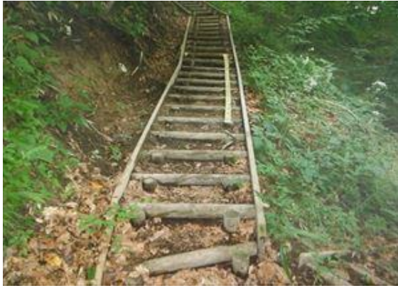
破損して危険な木製階段
