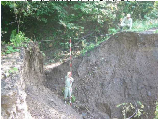
林道の路体流出(空知署管内)
