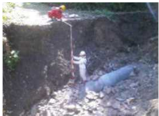
林道の管渠閉塞、路体流出(空知署管内)
