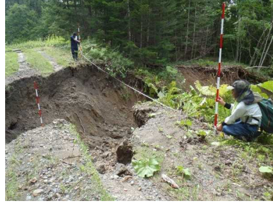
林道の路体流出（日高北部署管内）
