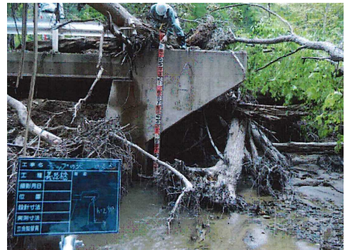
橋台の洗堀状況の調査
