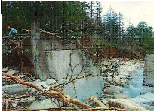
林道の橋梁の流出状況の調査
