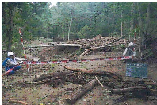
林道の路体流出状況の調査
