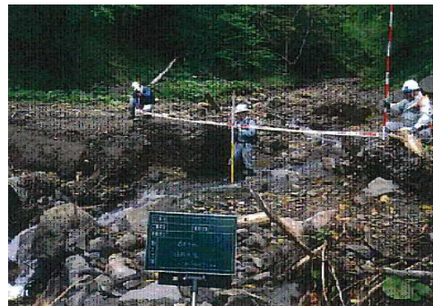
暗渠の閉塞による路体流出状況の調査
