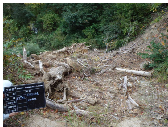
(土砂崩壊箇所)
