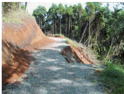
路肩決壊の状況
