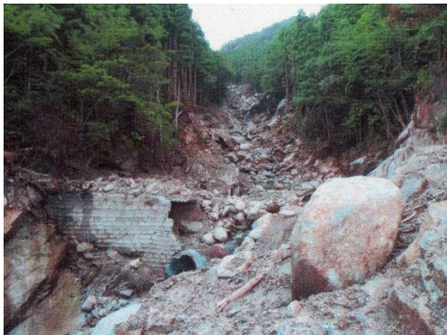
土石流による既設道破壊の状況
