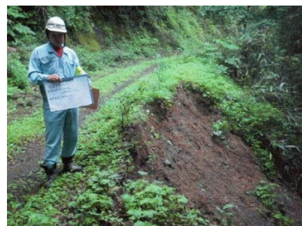
路肩決壊の状況
