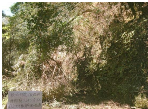
法面崩落の状況
