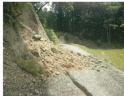
法面崩壊の状況
