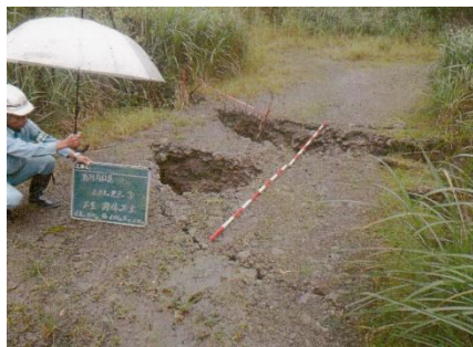
路面の陥没状況
