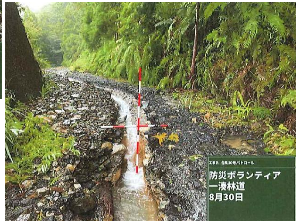
屋久島署：路面洗堀の状況
