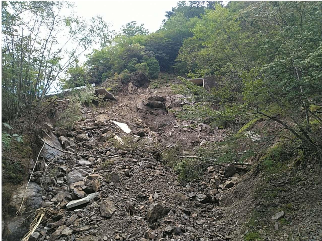
宮崎北部署：路体決壊の状況
