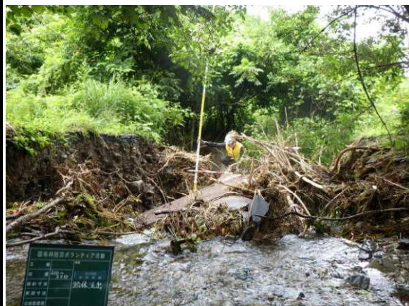
水沢林道（路体流出）
