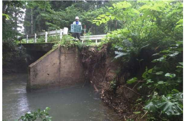
金平林道（金平橋路肩崩壊）
