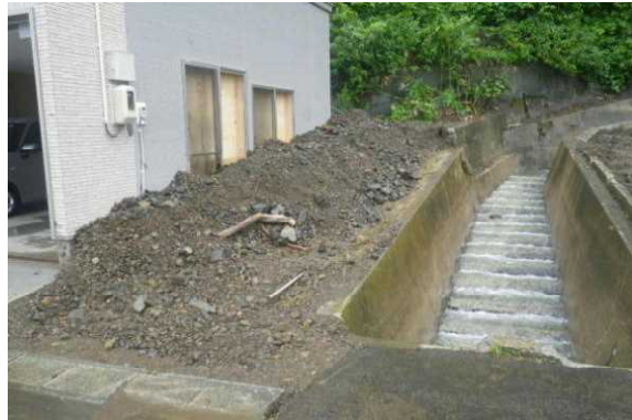
平舘地区（沢からの土砂流出）
