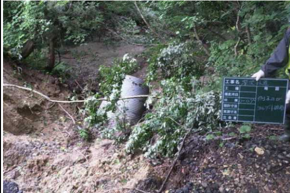
深沢林道（倒木及びコルゲート破損）
