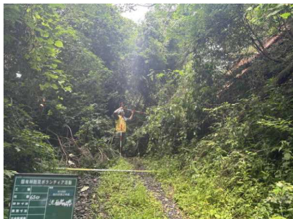
岩の沢第2林道（法面崩落）
