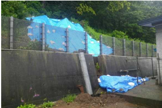
平舘地区（法面崩壊）
