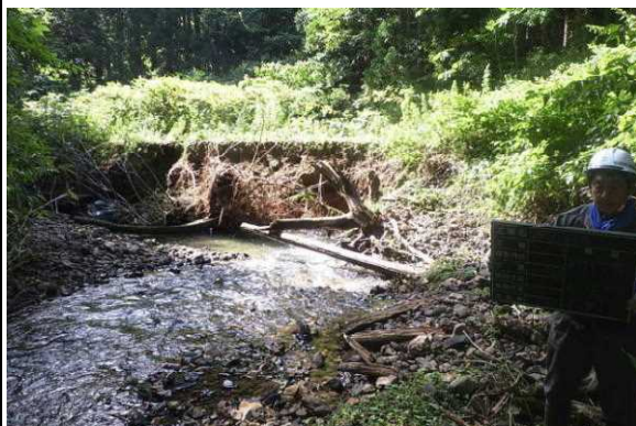
母沢林道（路肩決壊）
