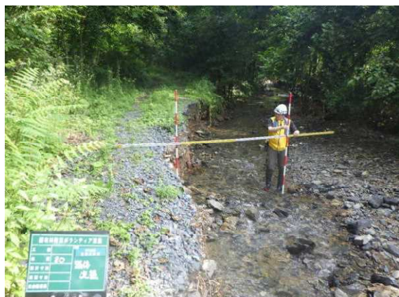
石積沢林道（路体洗掘）
