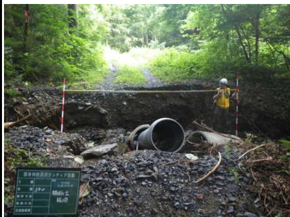
岩の沢第2林道（横断工損傷）
