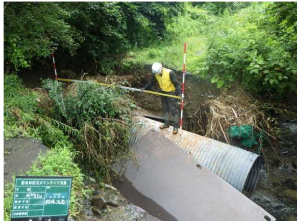
水沢林道（路体流出）
