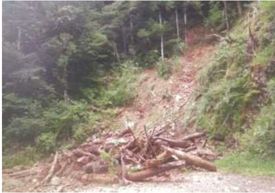
8月16日 林道法面の崩落
