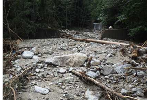
既設治山ダムが土砂に埋没
