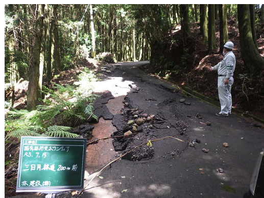
林道路面の洗堀
