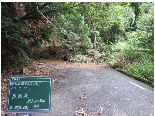
北薩署 林道法面の崩壊
