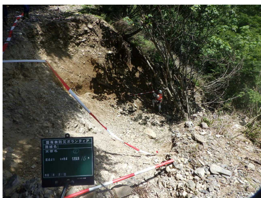
熊本南部署 林道路体の決壊
