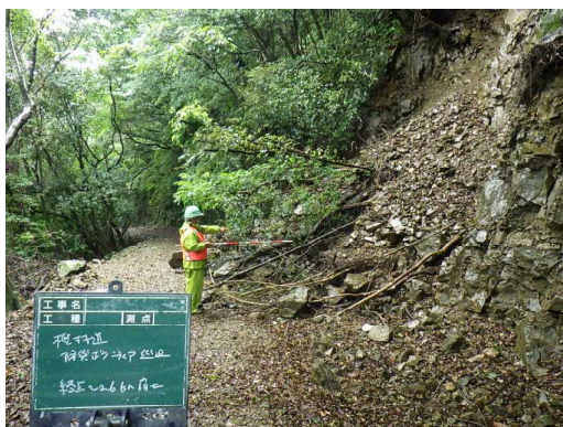
西都児湯署 林道法面の崩落
