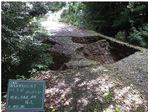
北薩署 林道路体の陥没
