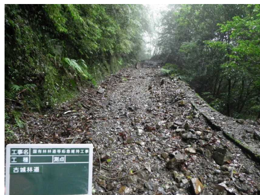
林道路面の洗堀
