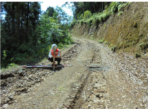
都城支署 林道路面の洗堀
