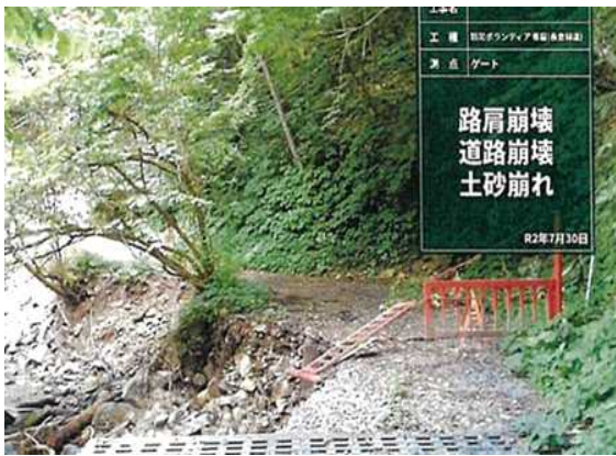
林道ゲートの被害状況(電子黒板)
