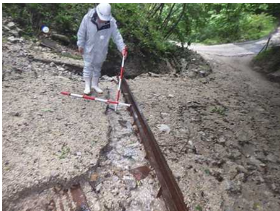
林道の路面洗堀を確認
