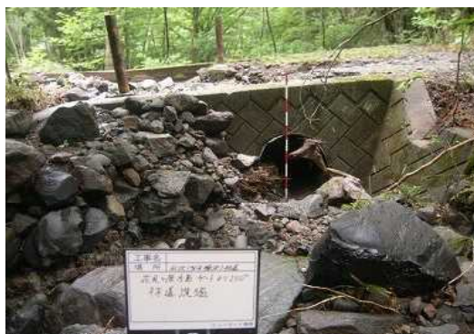
暗渠閉塞の状況
