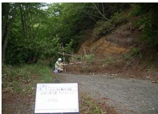
法面崩壊の状況
