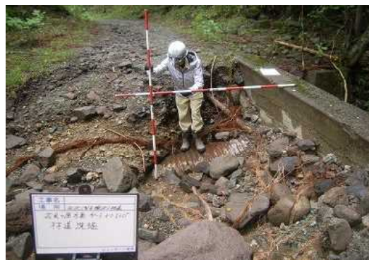
路面洗堀の状況
